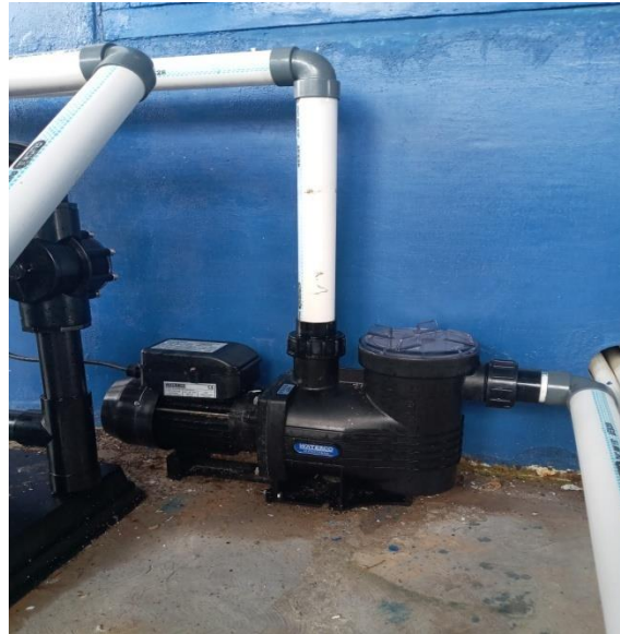
Gambar 10. Pompa air laut
