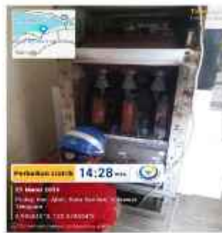
Gambar 10. Ledakan kabel jaringan listrik PLN
