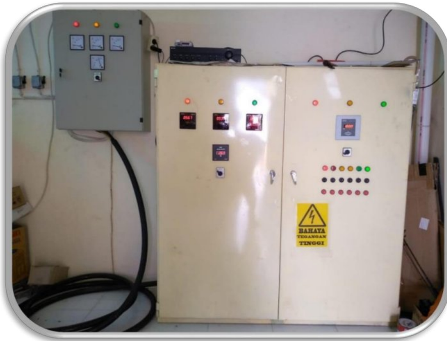
Instalasi Listrik Luas 230 KVA
