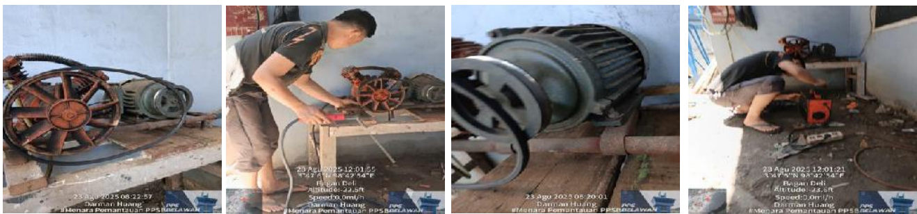
Pemeliharaan mesin pompa air di Kantor Syahbandar
