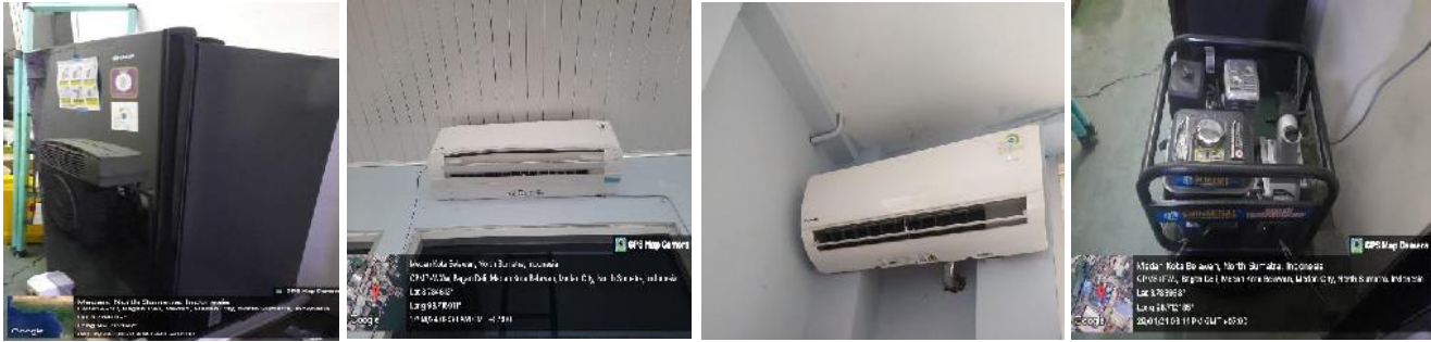
Pengadaan Mesin Pompa Air, Pengadaan AC dan Pengadaan Lemari ES
