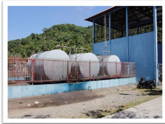
Gambar 9 Sarana Penyaluran BBM Solar
