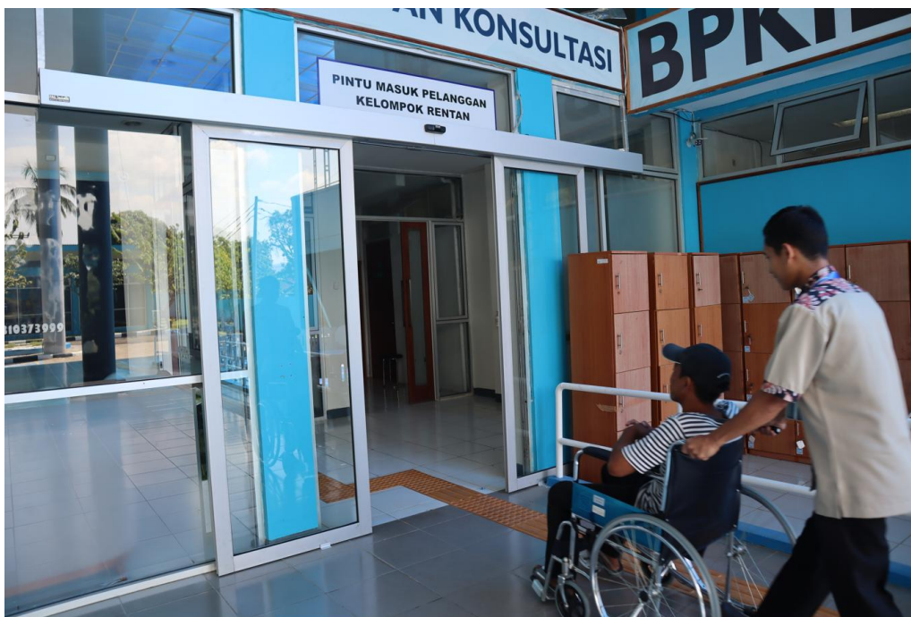
Gambar 18. Pintu Otomatis (Pintu Masuk Kelompok Rentan)
