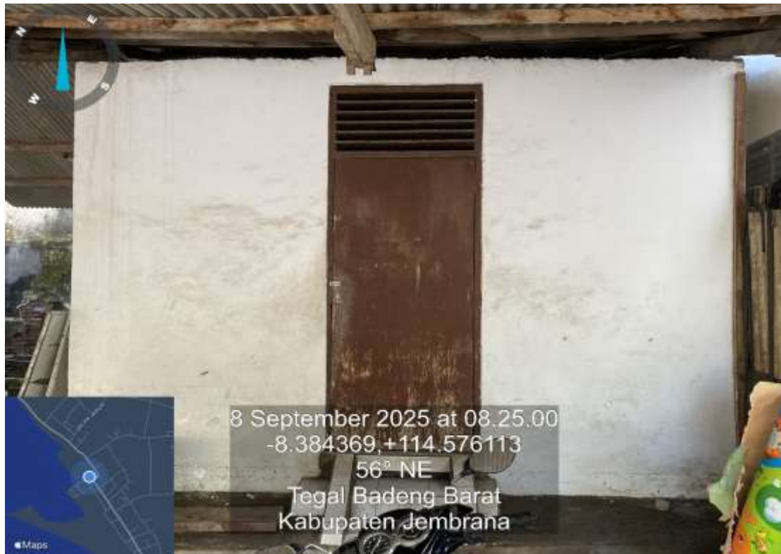
Rumah Genset Mess
